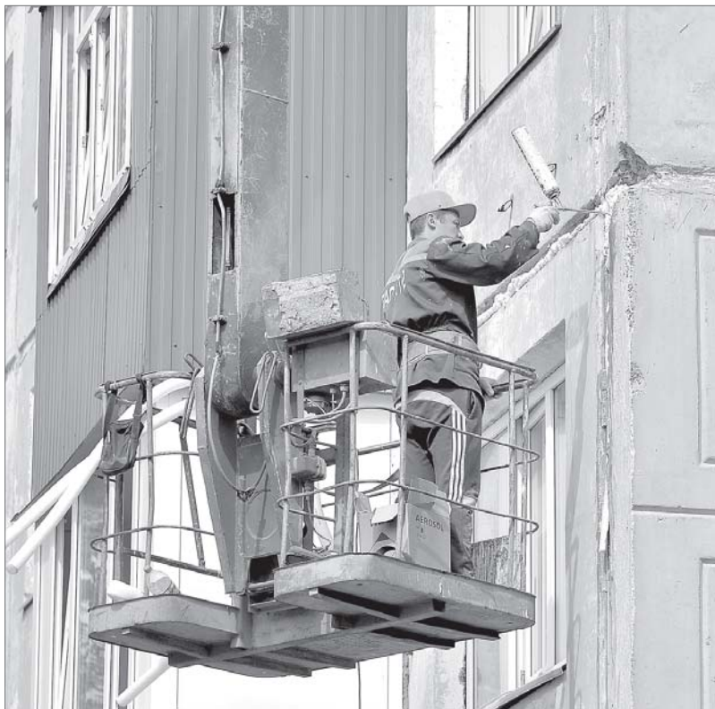
Управляющая компания №2 ведёт работы по герметизации межпанельных швов дома 8-Б по ул. Интернациональной.
