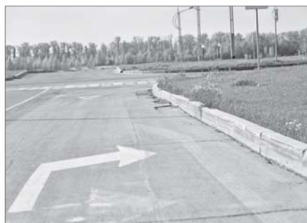
Бордюрный камень на этом участке дороги подлежит замене.
