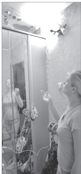
Мария Шубина показывает последствия затопления в своей квартире.
